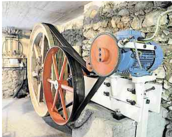
Stromgenerator, angetrieben vom Wasserrad der Oberen Mühle.
